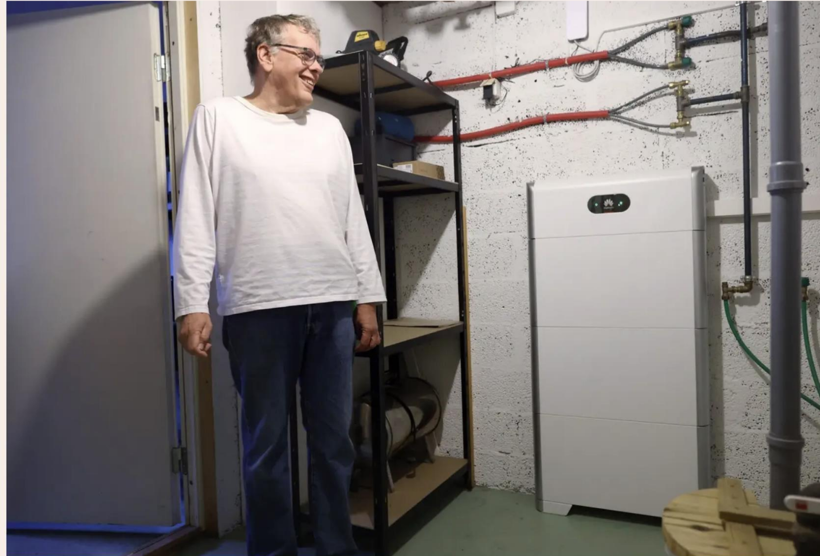
Espoolainen Timo Raito hankki omakotitaloonsa syyskuun puolivälissä kotiakun. Se lataa sähköä silloin kun sähkö on halpaa ja purkaa sitä, kun sähkö on kallista. Elisa hallitsee akkua etäohjauksella. Kuva: Sami Kero / HS
